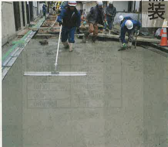
観光客らが多く通る小路で施工したワンデイペイブ。翌日には表層工の作業に入った
